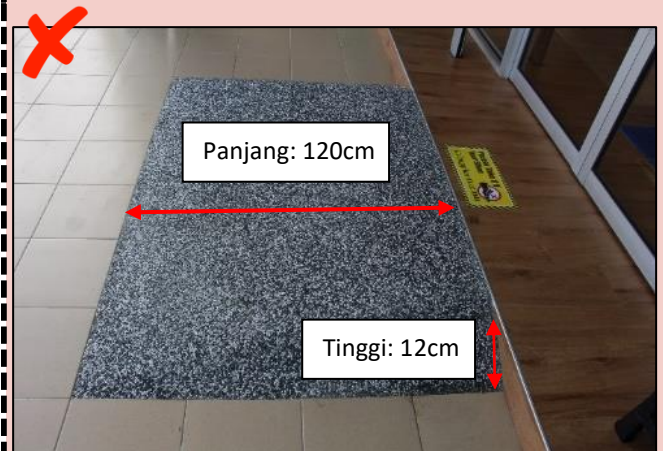
Ramp di hadapan pintu masuk klinik dengan nisbah kecerunan 1:10 adalah tidak patuh
